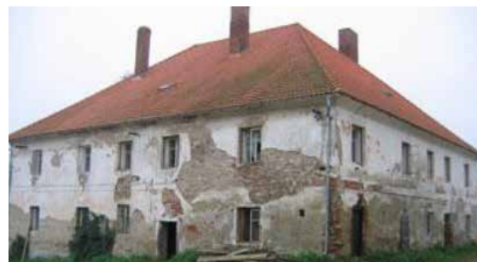
Tristní stav tvrze před opravou.
